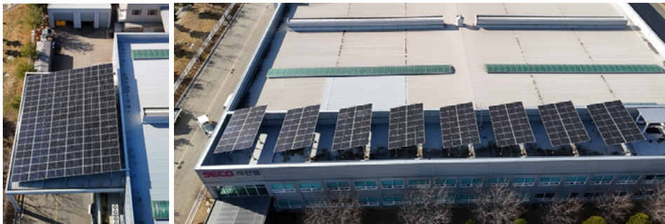
태양광 발전 설비
